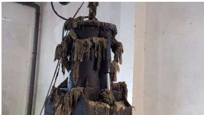
El 'monstruo' de 200 toneladas de toallitas que atasca las tuberías cada año en Mérida
