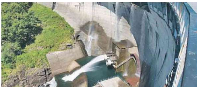
La presa de Eiras tiene dos de sus cuatro válvulas dañadas.
