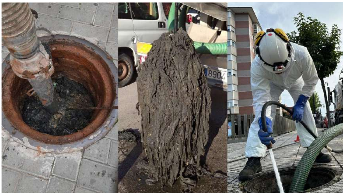
Residuos retirados de las tuberías. / E. S.
